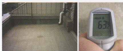
▲ガイナ塗布前のベランダのコンクリート表面温度は、63.2℃ (外気温33℃)。
